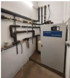
Le Village olympique à Saint-Denis est équipé d'un système de récupération d'eau de pluie.
