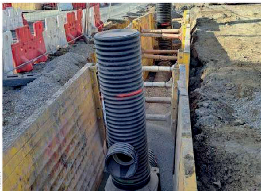
Chez Fränkische, un substrat adsorbant peut compléter l'action de solutions de sédimentation comme ce Sedipe installé à Port-la-Nouvelle (Aude).
